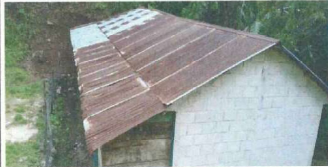
Foto 2: Se identifica que la cubierta de láminas se encuentra en mal estado, presentando deterioro y en época de lluvia se filtra el agua.
