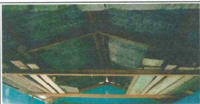
Foto 3: Se observa que la estructura del techo se encuentra en mal estado, presentando desgaste en la madera.
