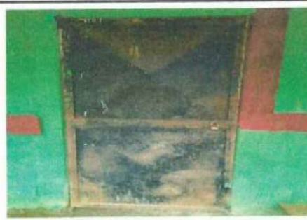
Foto 6: Se identifica que las puertas del establecimiento se encuentran en mal estado.
