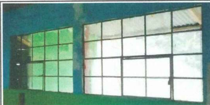
Foto 4: Se observa deterioro y desgaste en la estructura metálica de las ventanas como en los vidrios de las ventanas.
